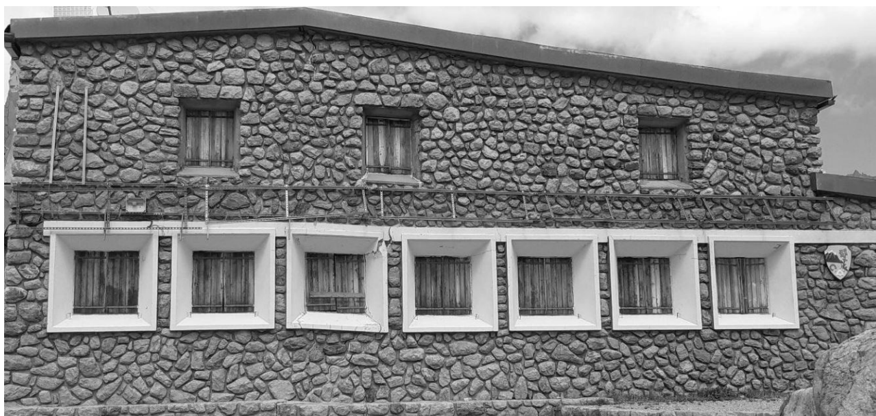
Le refuge de La Pilatte, définitivement fermé depuis juin 2021. Cherchez la fissure qui condamne ce refuge...
